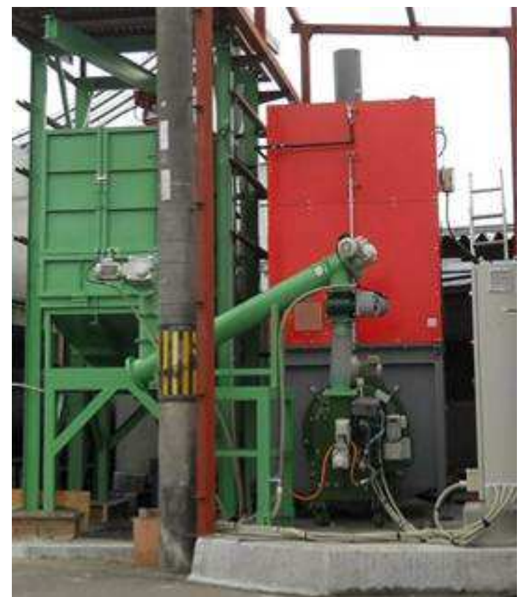
バイオマス燃焼ボイラの外観
