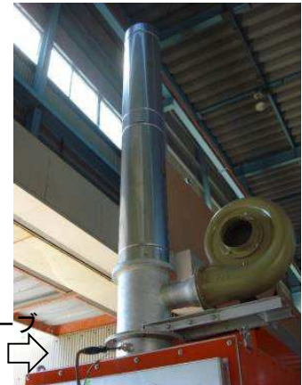
写真2 煙突出口の測定状況
